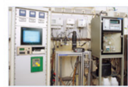
Messeinrichtung in der Messstation
