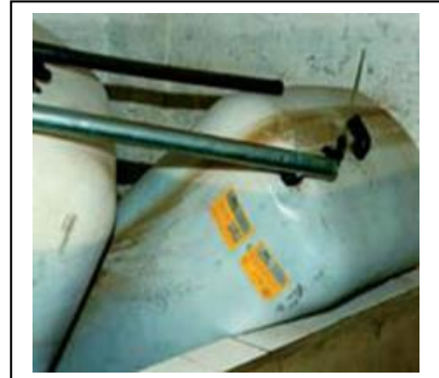
Ungeeigneter Heizöltank nach einem Hochwasserereignis
