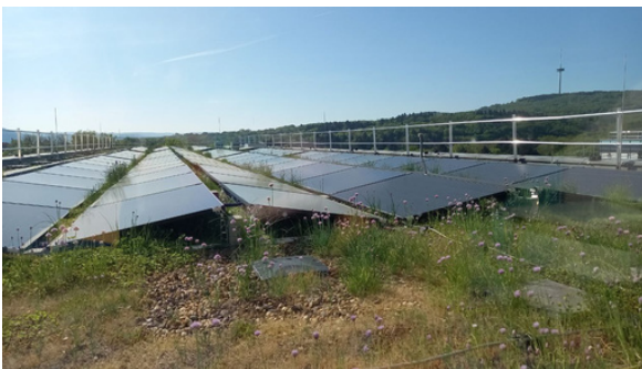
Extensive Dachbegrünung in Kombination mit PV (Hochschule Koblenz, K. Plokarz 2025)
