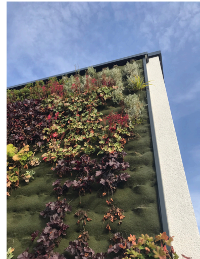
Fassadengebundene Begrünung in Koblenz (D. Spurzem, 2024)
